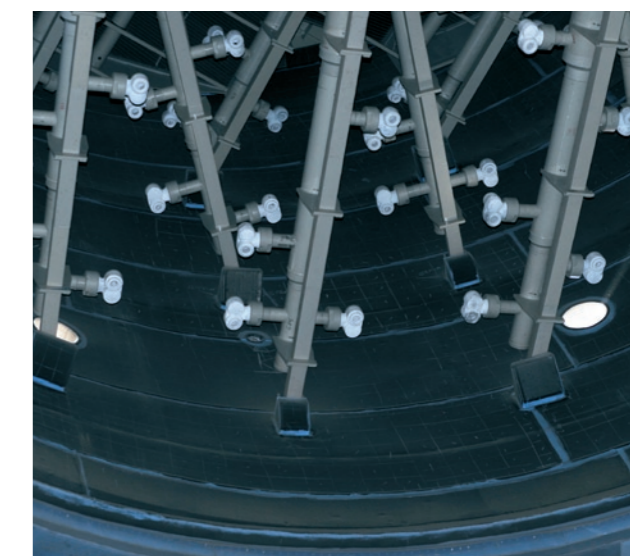
Detail pogumování technologických částí zařízení Detail of equipment technological parts rubber lining
