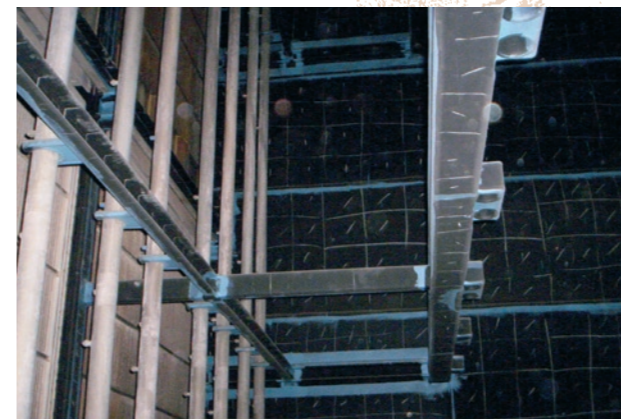
Detail pogumování technologických částí zařízení Detail of equipment technological parts rubber lining
