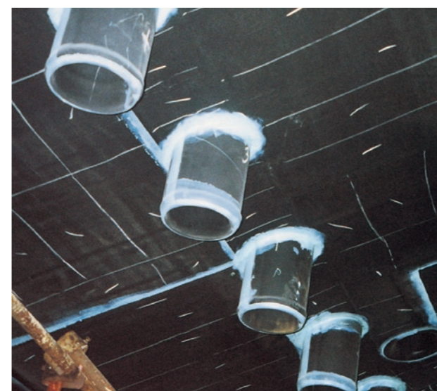
Detail pogumování technologických částí zařízení Detail of equipment technological parts rubber lining
